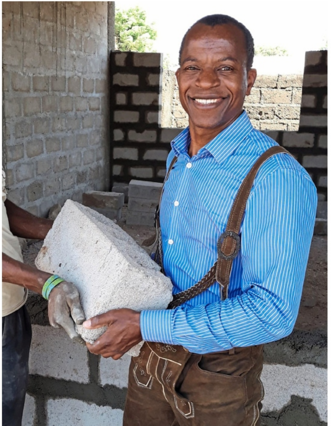
Ibrahim Ismael packt auf der Baustelle mit an. Mit dabei: die Lederhose aus der neuen Heimat.
